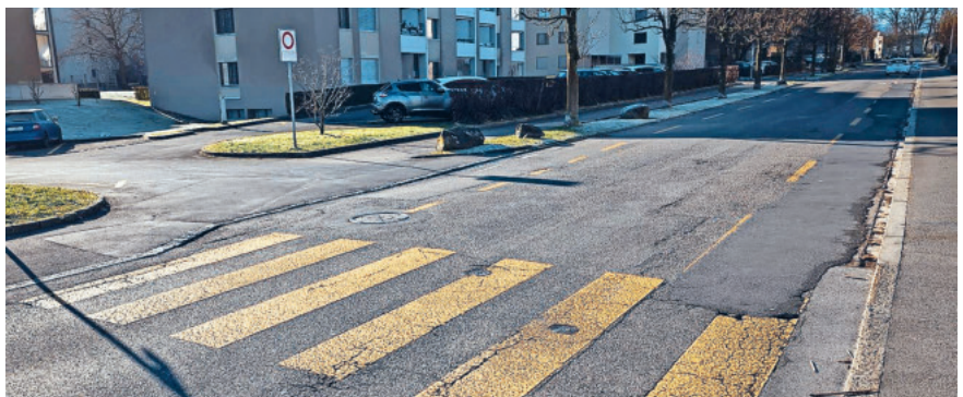
Die Haldenstrasse weist sowohl bei den Werkleitungen als auch im Strassenraum Sanierungsbedarf auf. (Bild: Gemeinde Emmen)
