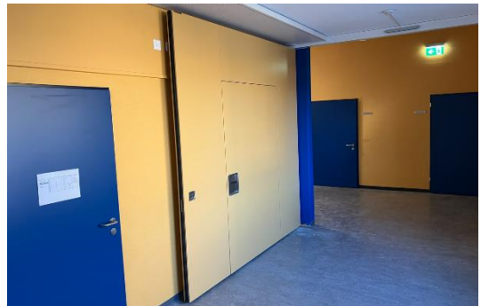
Abbildung 8: Neues Brandschutztor Verbindungstrakt
